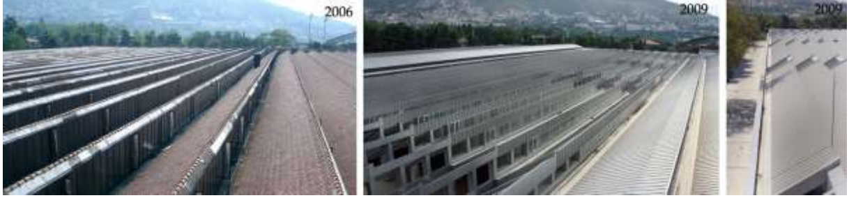
Şekil 18: İplik Fabrikası Şed Çatısının Dönüşümden Sonraki Hali Ve Üzerinden Açılan Yarıklar
