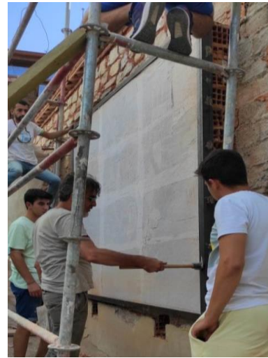
Şekil 7. Köylü Pazarı mozaik pano metal çerçevenin yerleştirilme işlemi (Tülay Özkul'un kişisel arşivinden)
