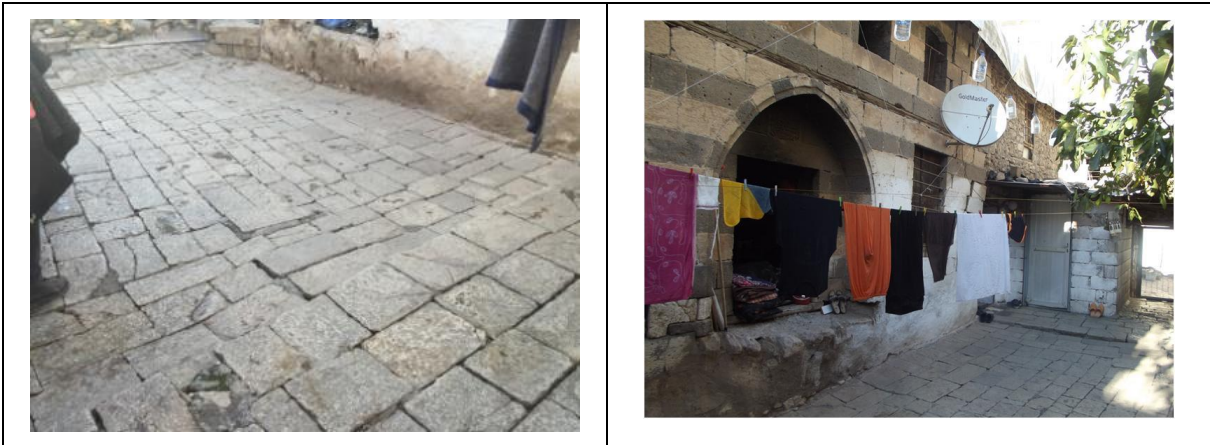
Şekil 10. Sinagog Yapısındaki Bozulmalara Örnek
